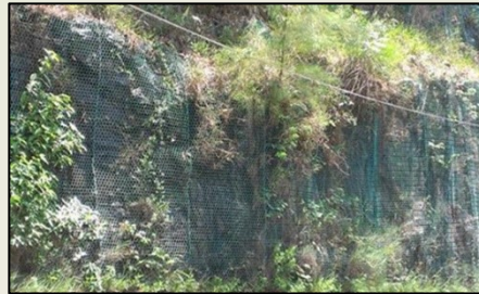
侵蝕控制, 吐露港公路 2012年8月
